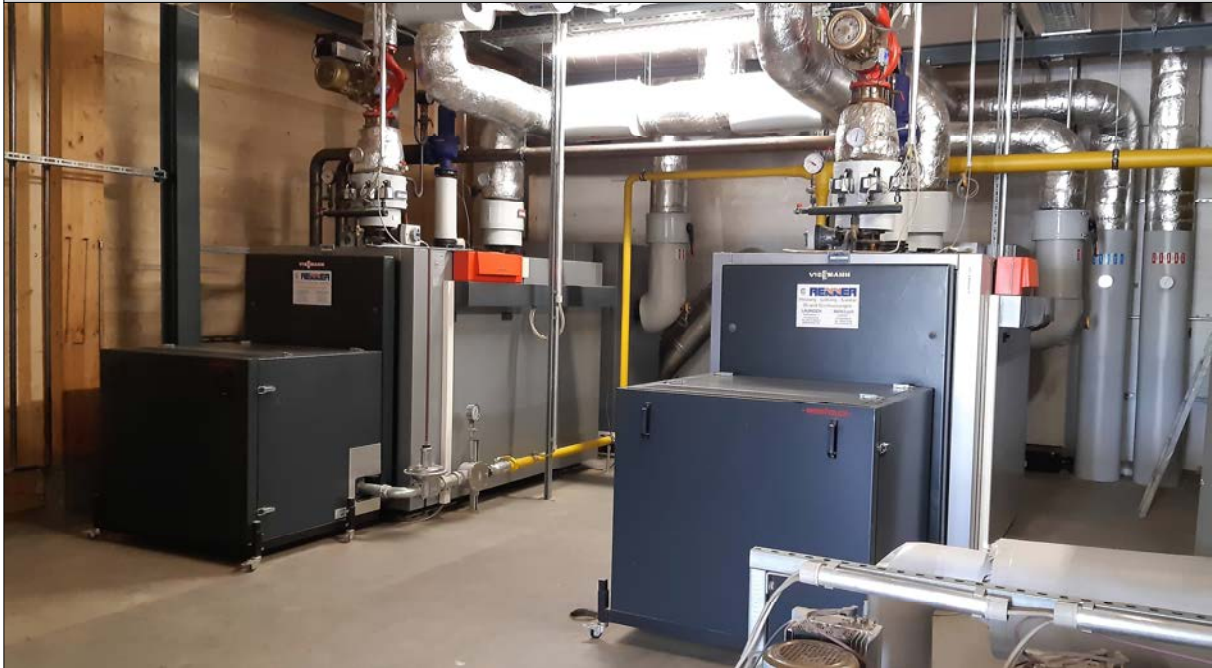
Zwei Niedertemperaturkessel (Heizzentrale nördlich vom Gymnasium)
