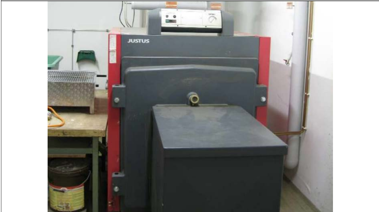
Heizöl-Niedertemperaturkessel (Heizraum im UG)
