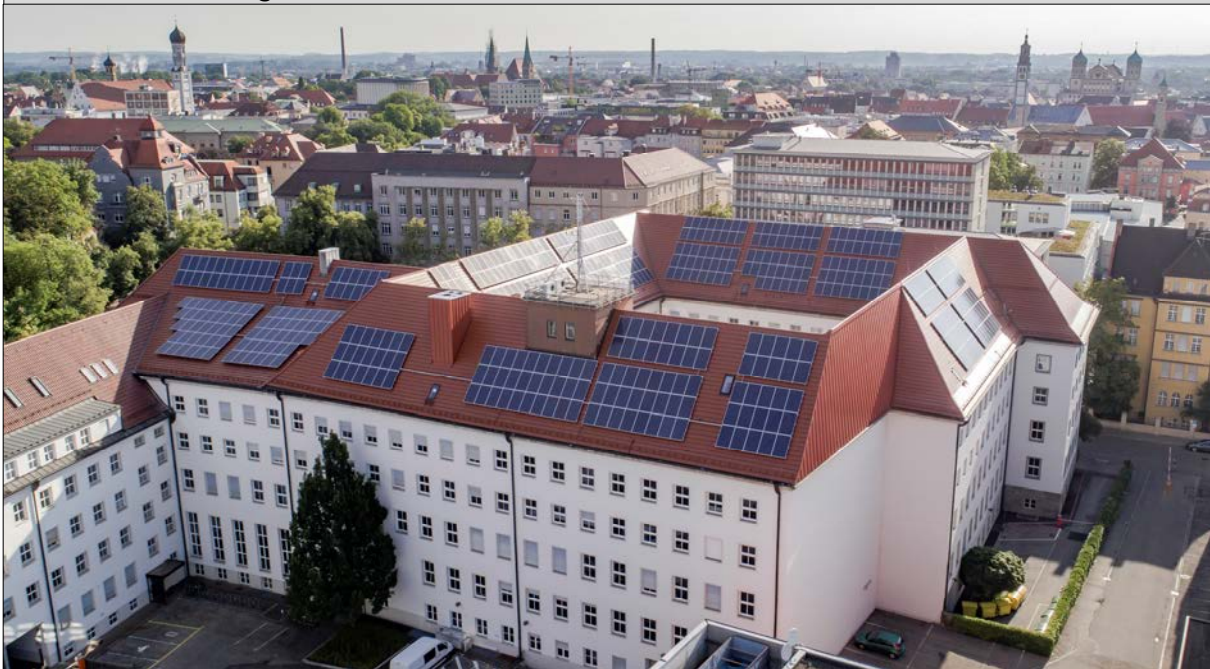
Photovoltaikanlage (Ansicht von Südwesten)
