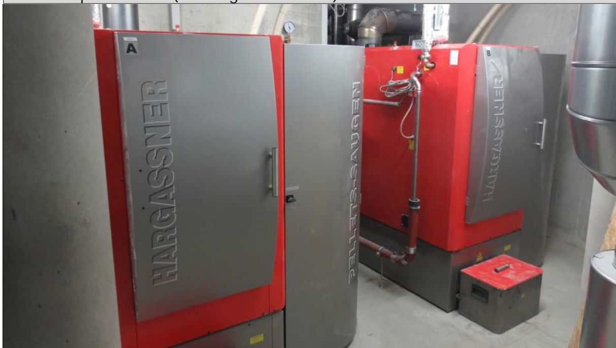
Zwei Holzpelletkessel (Heizungsraum im UG)
