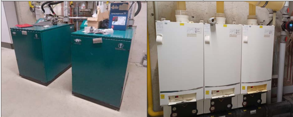
Zwei BHKW und drei Brennwertthermen (Heizraum im UG)
