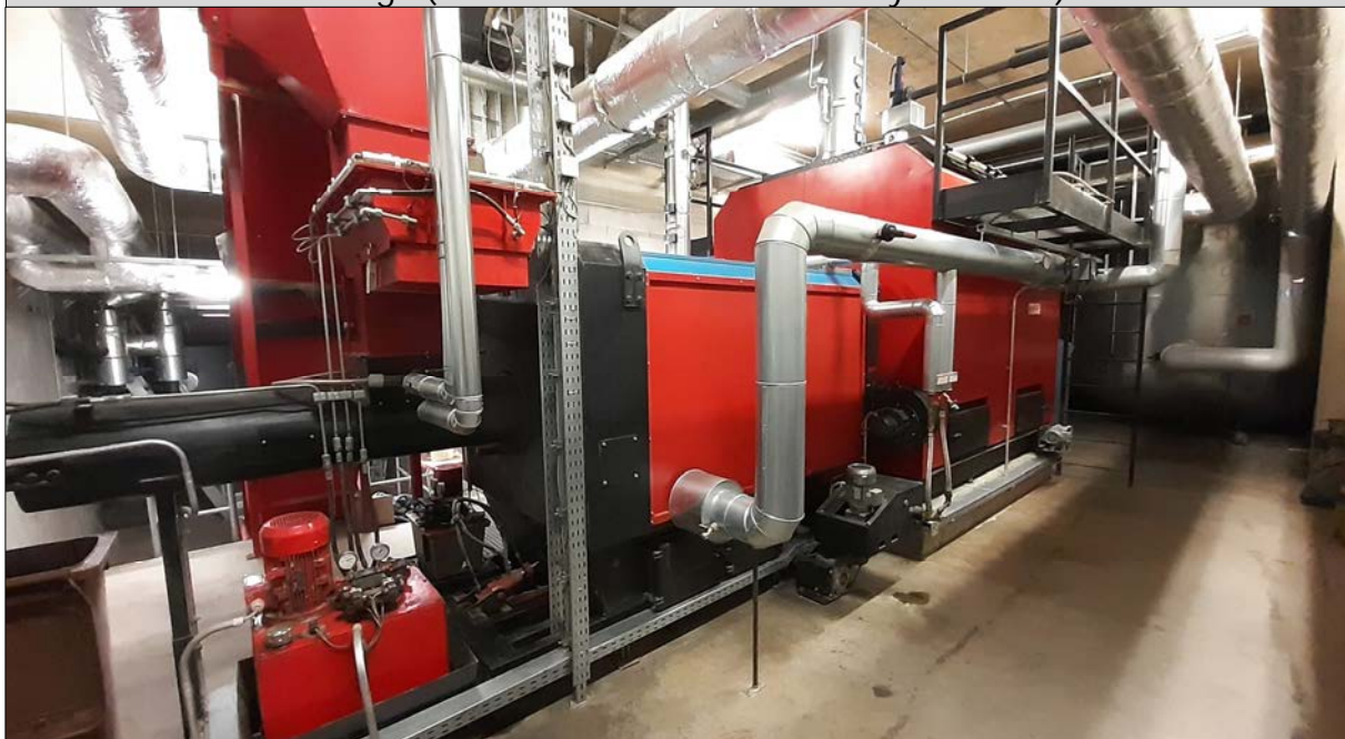
Holzhackschnitzelanlage (Heizzentrale nördlich vom Gymnasium)
